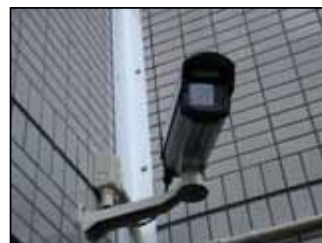
立体駐車場カメラ
