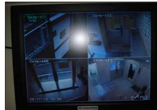
管理事務室モニター
